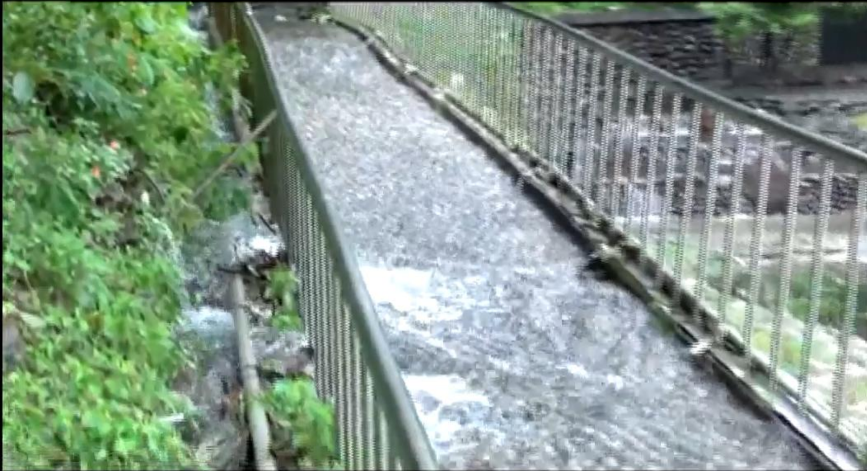
▲下雨天步道变渠道
