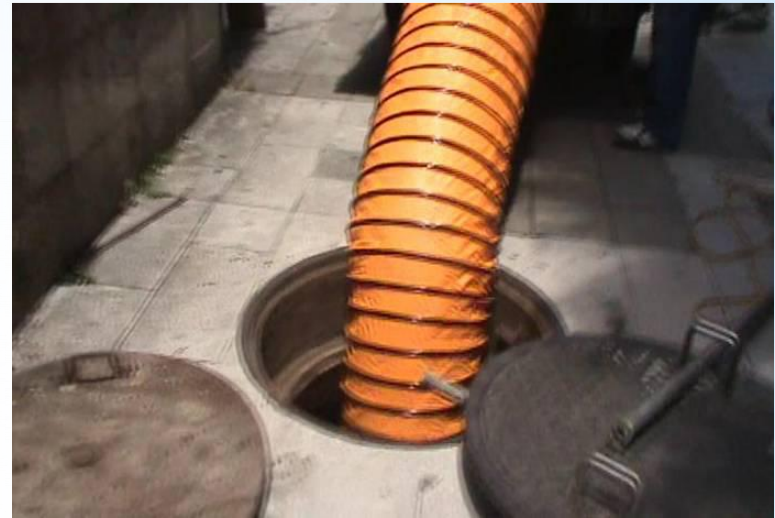
2. 进入管道前先通风换气达30分钟以上
